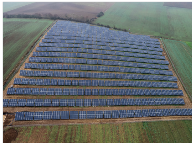
Solarpark mit einer Leistung von 2 MWp, Konstruktionstyp: W-V2G2-BI-25°, Woiwodschaft Pommern (Polen)
